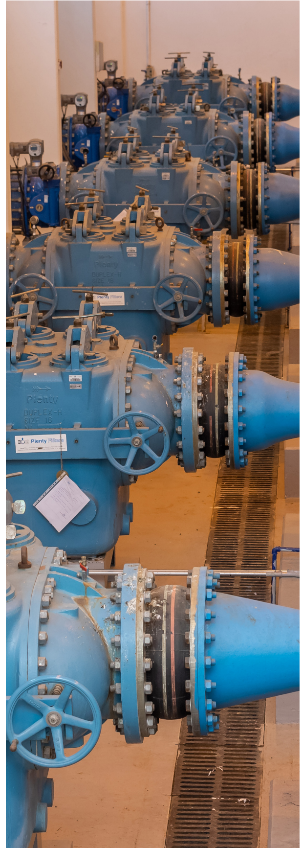
مضخات لتوزيع المياه، شركة المياه الوطنية
