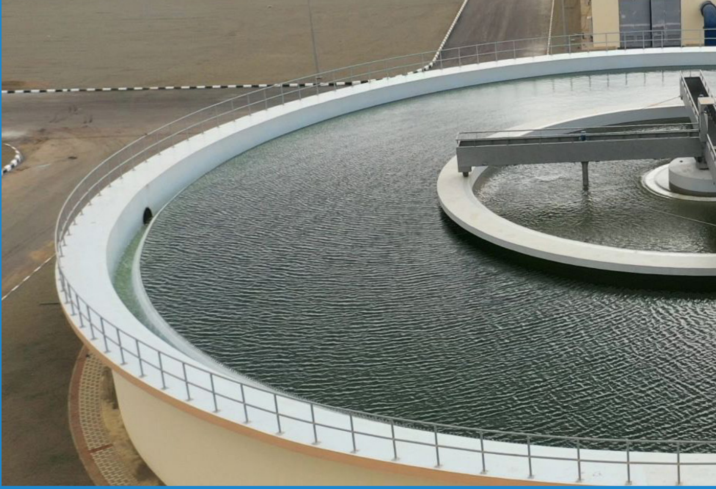
خزان الترسيب في محطة معالجة مياه الصرف الصحي، شركة المياه الوطنية
