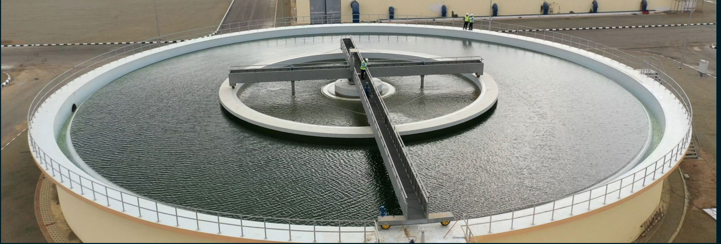
خزان الترسيب في محطة معالجة مياه الصرف الصحي، شركة المياه الوطنية
