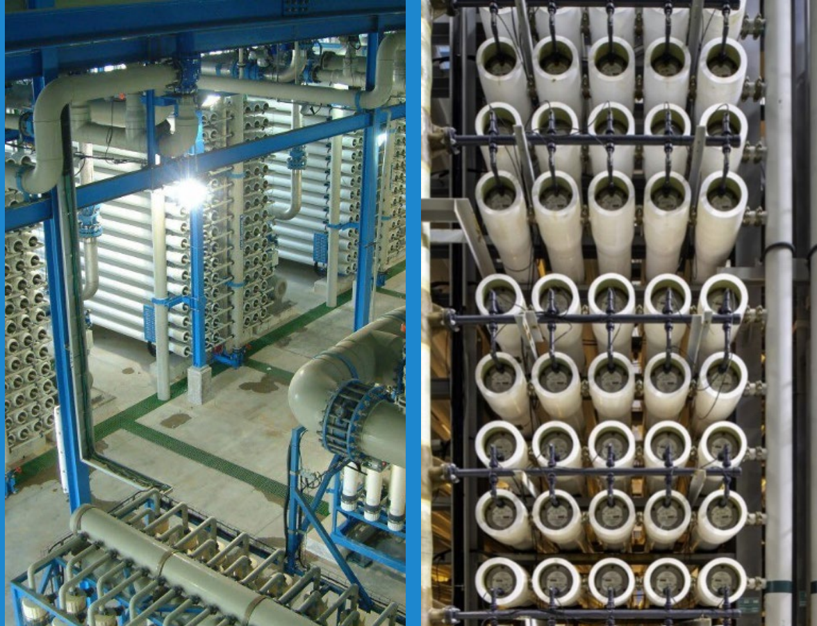
معدات التناضح العكسي داخل محطة لتحلية المياه المالحة، المؤسسة العامة لتحلية المياه المالحة
